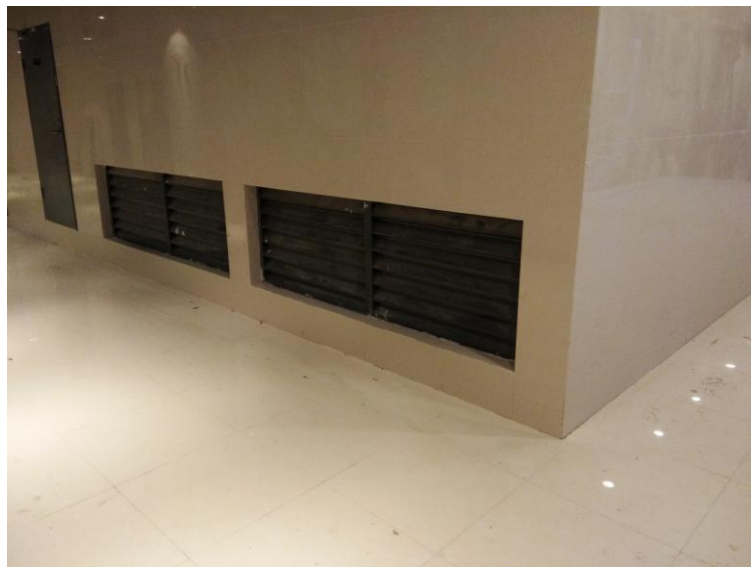
12-2#楼发电机排风口
